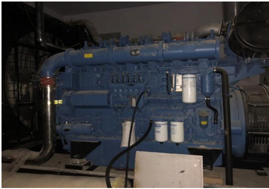
地下发电机房
