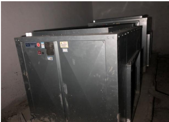
地下停车库排风机
