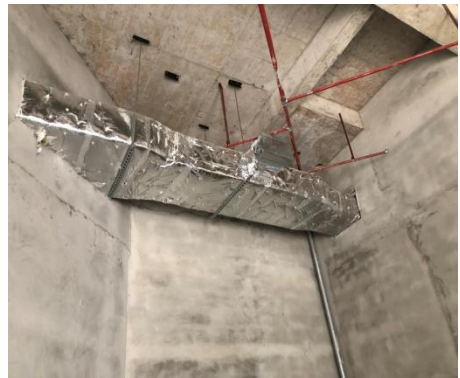
油烟排放管道
